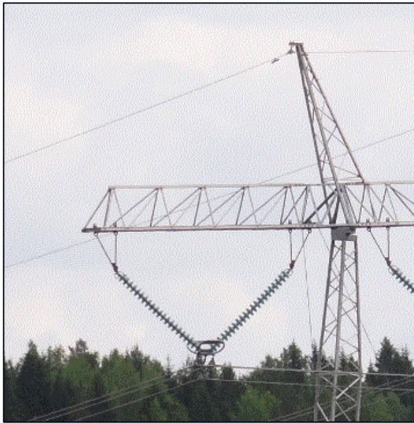
Kuva 63. Voimajohtopylvään eristimiä, joissa koronapurkauksia voi esiintyä.
