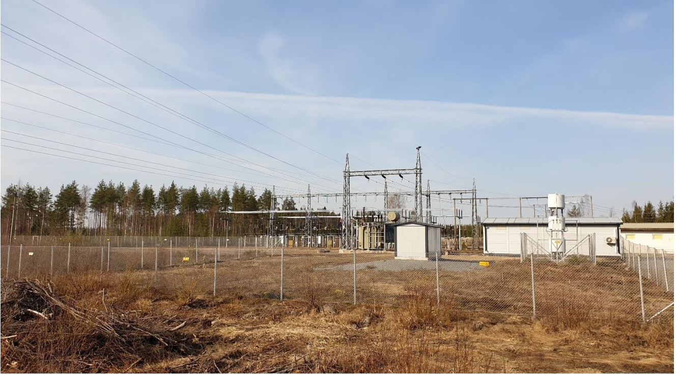
Kuva 57. Esimerkki sähköasemasta, jonka kokoluokka vastaa Juthskogenin tuulivoimapuiston omaa sähköasemaa.
