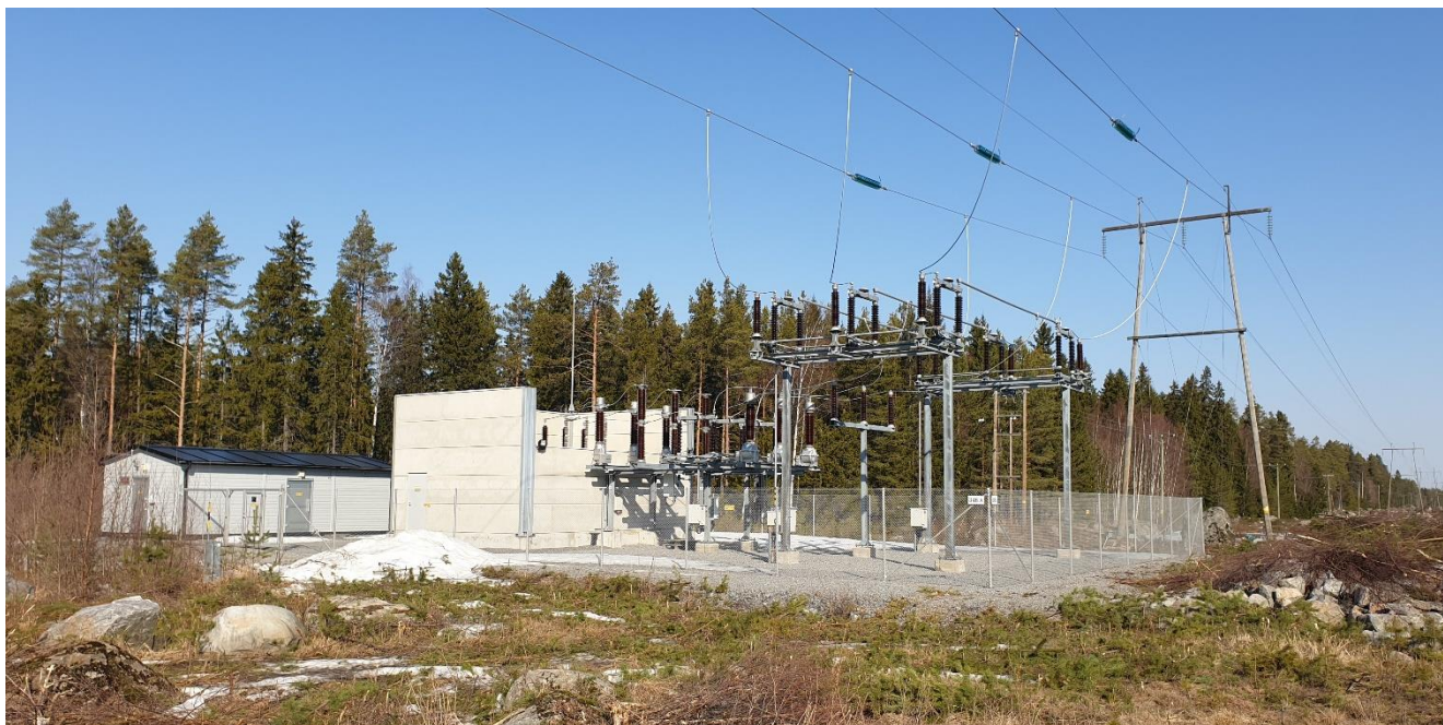
Bild 16. Exempel på elstation. Bild: Toni Lustila
