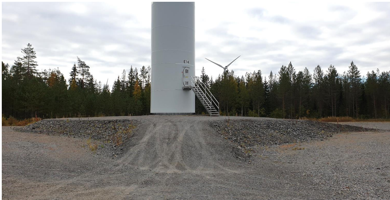
Bild 9. Exempel på ett stålbetongfundament som är täckt med kross. Bild: Toni Lustila
