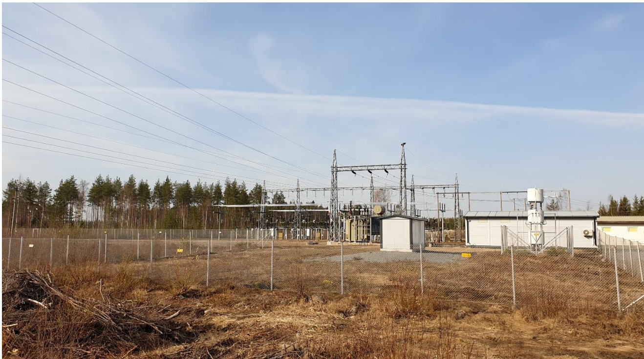
Bild 57. Exempel på en elstation som storleksmässigt motsvarar Juthskogens egen elstation.
