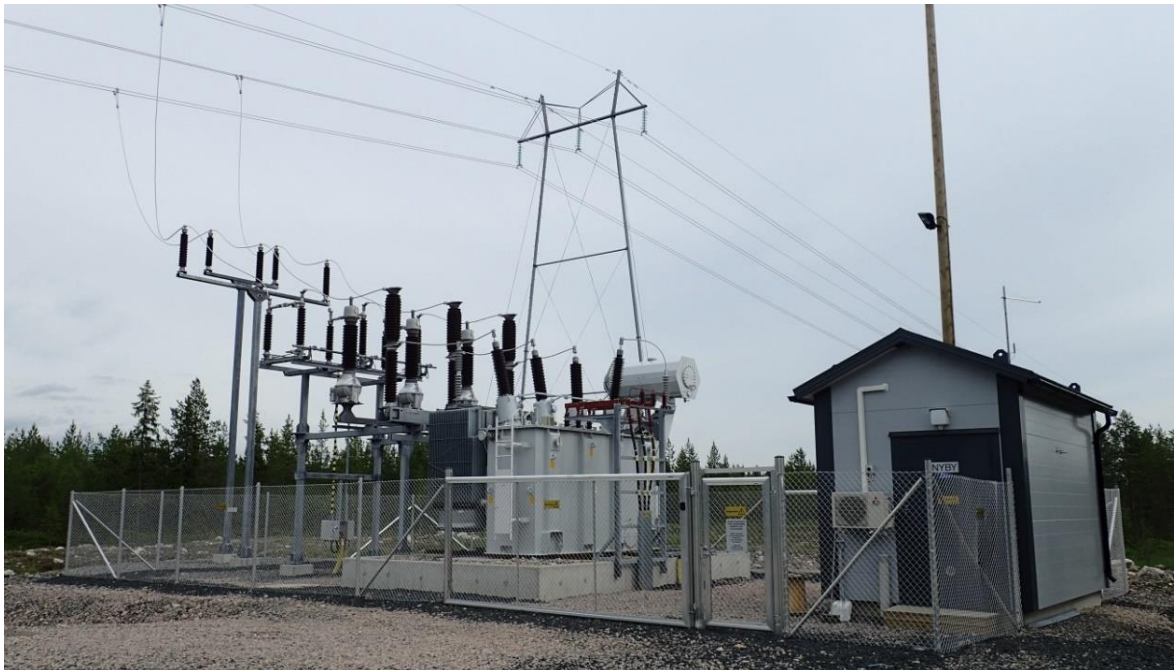
Kuva 5-8 Esimerkki tuulivoimahankkeen sähköasemasta (FCG Finnish Consulting Group Oy).
