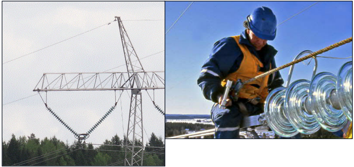
Kuva 6-3. Voimajohtopylvään eristimiä, joissa koronapurkauksia voi esiintyä.
