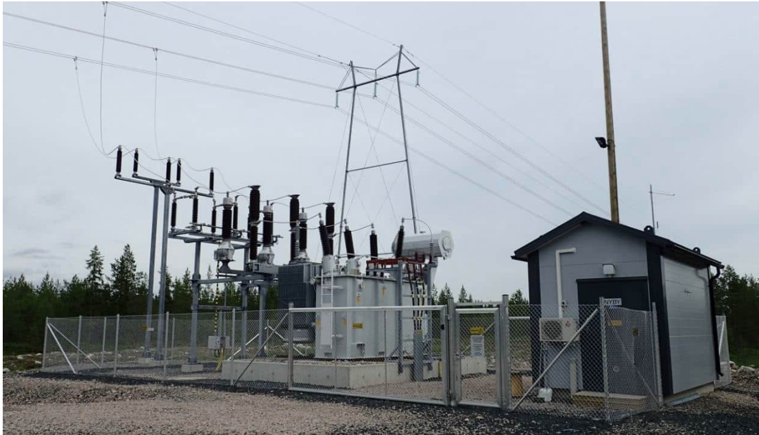
Kuva 5-9. Esimerkki tuulivoimahankkeen sähköasemasta (FCG Rakennettu Ympäristö Oy).
