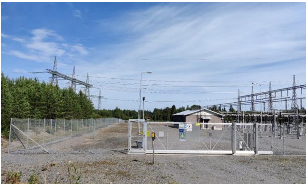
Kuva 32. Valokuvassa Fingrid Oyj:n 400 kV voimalinja ja sähköasema (Arkkitehtitoimisto Ajak Oy, 2022)
