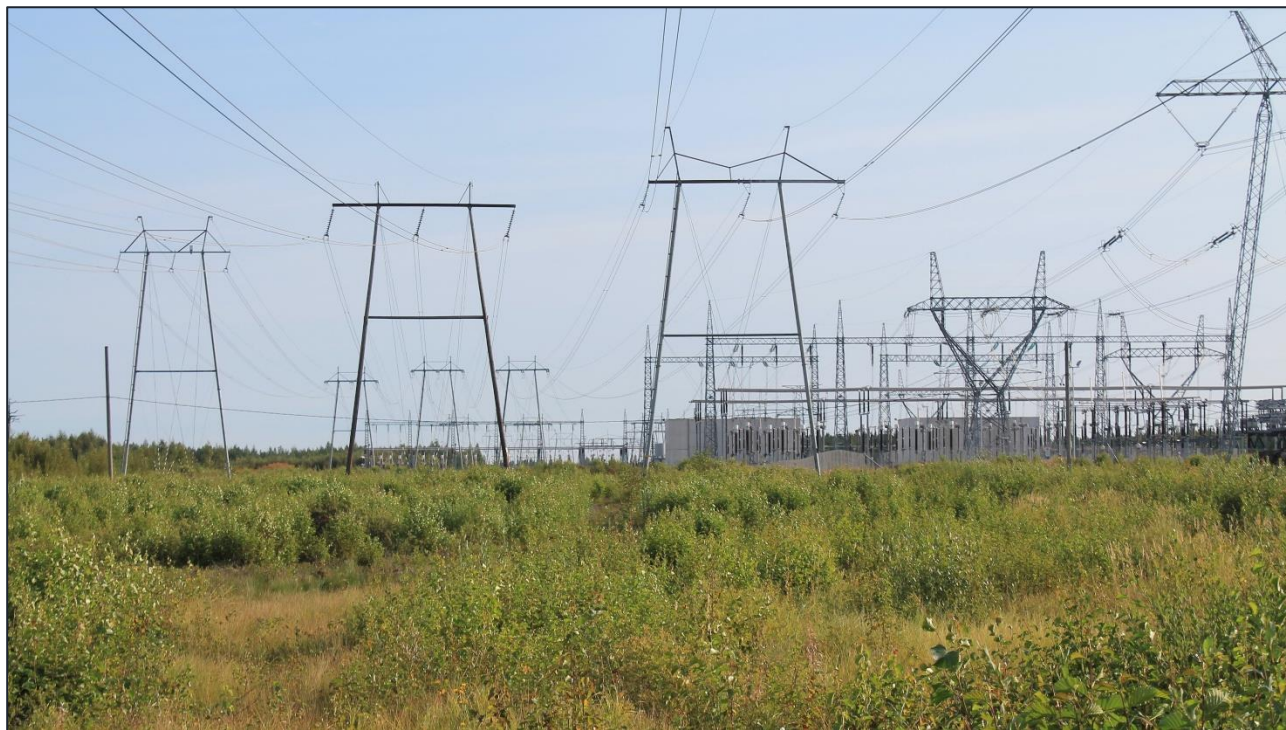
Kuva 1-7. Näkymää Hirvisuon sähköasemalle etelän suunnalta (© Koivumäki, O./ Envineer Oy, 2024).
