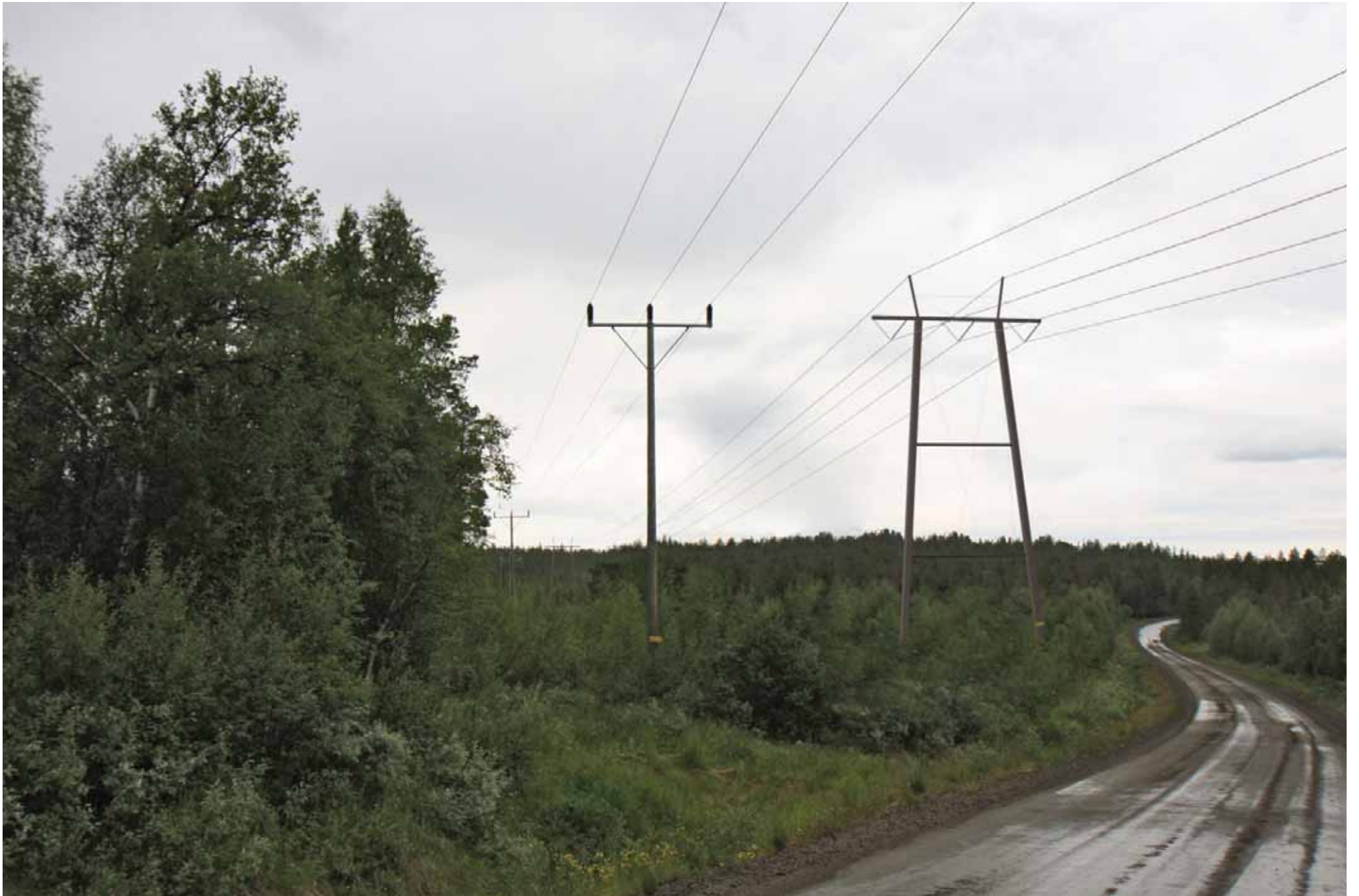
15) Voimajohto, Kerässiepiintien ylitys
