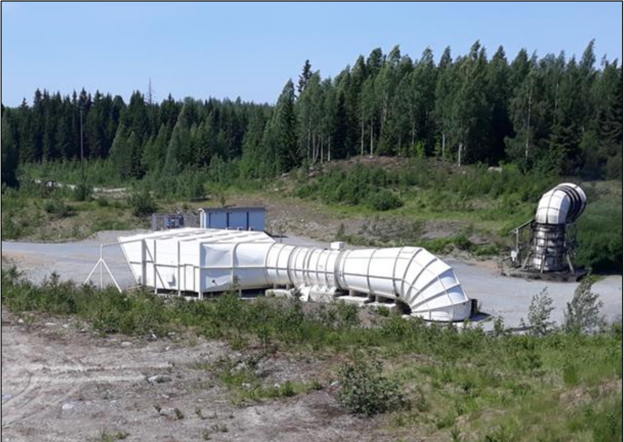
Kuva 15. Esimerkki tuuletusnousuista maanpinnalla (Kuva: Boliden Kylylahti Oy.)
