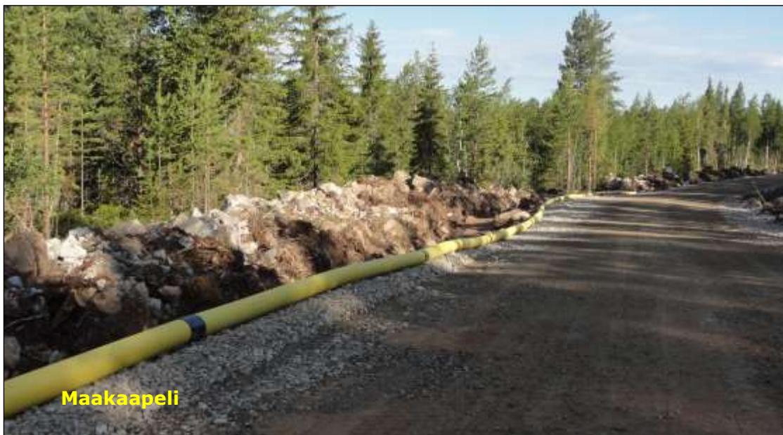
Kuva 5.6. Esimerkki tuulivoimapuiston rakennus- ja huoltotiestä. Teitä käytetään muun muassa betonin, soran ja voimaloiden komponenttien kuljetuksiin sekä tuulivoimapuiston käyttövaiheessa huoltoajoihin. Maakaapeli sijoitetaan ojakaivantoon tien reuna-alueelle (Kuva: Ville Suorsa / FCG).
