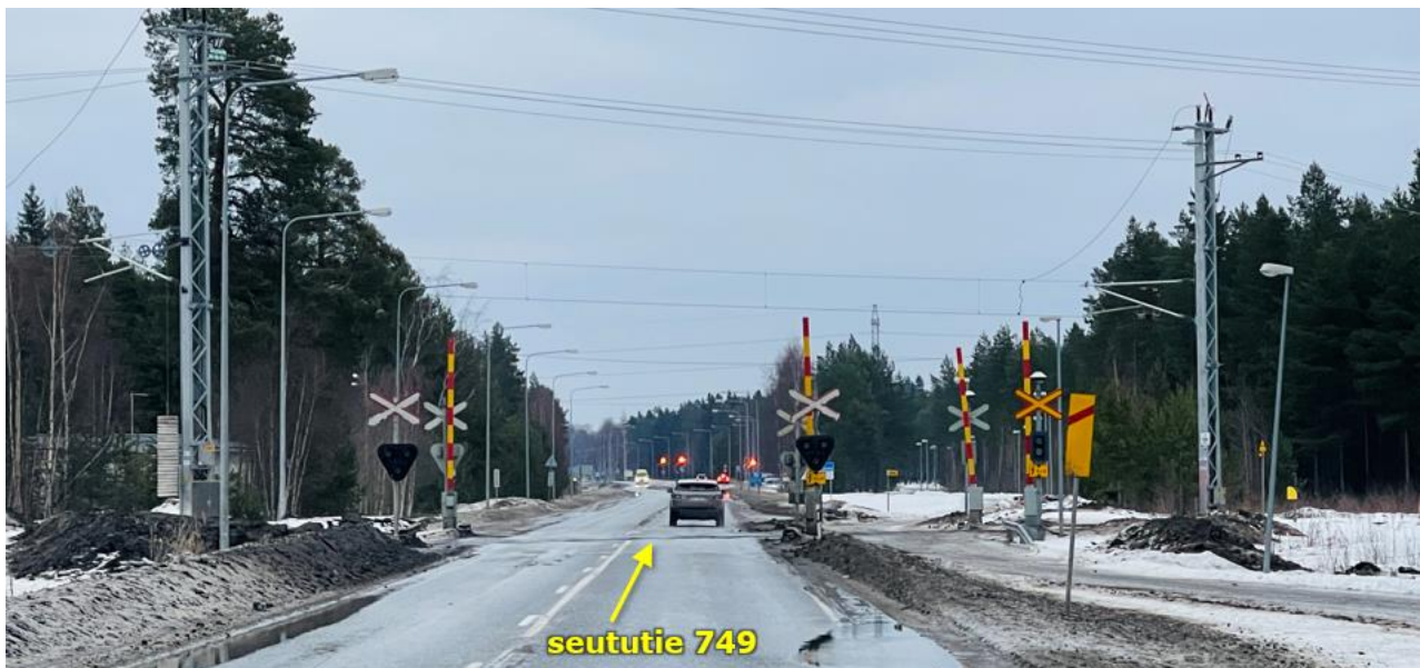
Kuva 5: Kokkolassa seututiellä 749 Varikon tasoristeyksessä on ajojohtimien nostolaitteisto.
