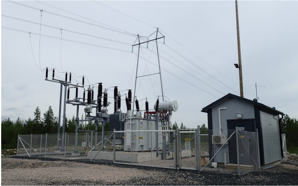
Kuva 4.9. Esimerkki tuulivoimahankkeen sähköasemasta.
