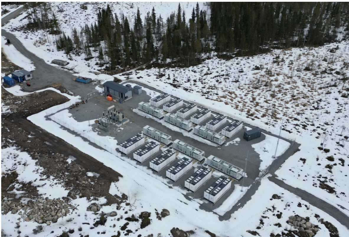
Kuva 4.8. Esimerkki sähkövarastosta. (Fortum)
