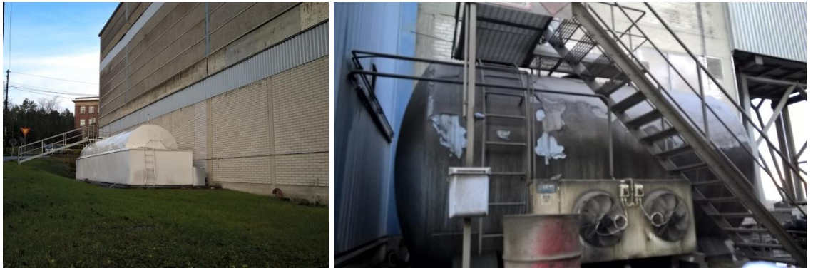
Kuva 4. Raskaspolttoöljy- ja kevytpolttoöljysäiliöt
