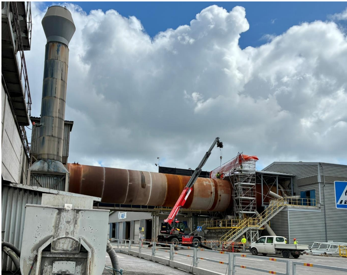
Kuva 3-10. Kiertouuni (kuva 3-3, kohta 7) maanpinnalta. Raakajauhe muuttuu uunissa klinkkeriksi kulkien vasemmalla oikealle. Uunissa savukaasut taas etenevät oikealta vasemmalle. Uunin jälkeen kuvassa oikealla olevassa harmaassa rakennuksessa sijaitsee arinajäähdyttäjä.
