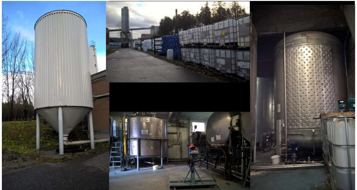
Kuva 9. Lisäaineiden varastosäiliöitä. Vasemmalla ulkotiloissa, keskellä alhaalla ja oikealla sisätiloissa ja ylhäällä keskellä tyhjiä lisäainesäiliöitä ulkovarastoinnissa.
