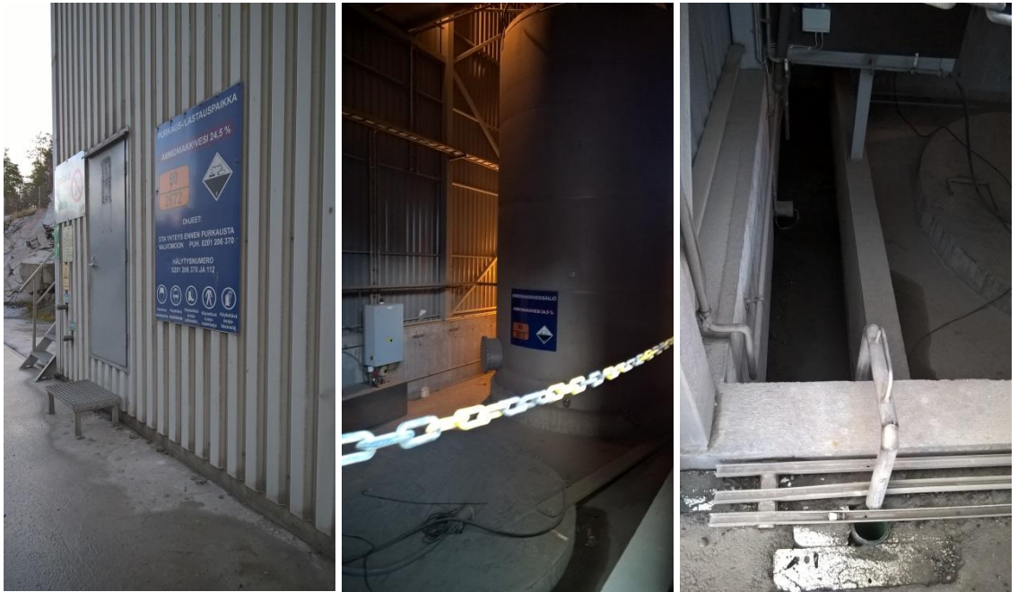
Kuva 8. Ammoniakkiveden täyttö, säiliö betonilla allastetussa tilassa sekä ylitäytön varalta suojatun tilan tyhjennys sadevesiviemäriin manuaalisesti.
