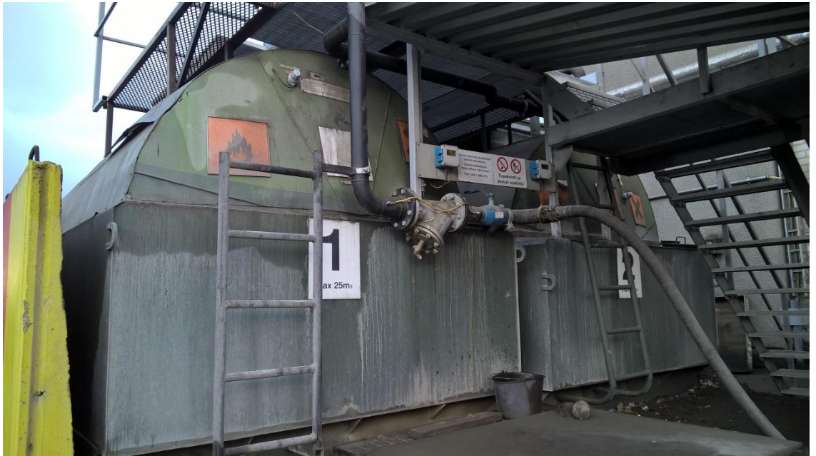
Kuva 5. Kierrätyspolttoöljysäiliö ja kevytpolttoöljysäiliö
