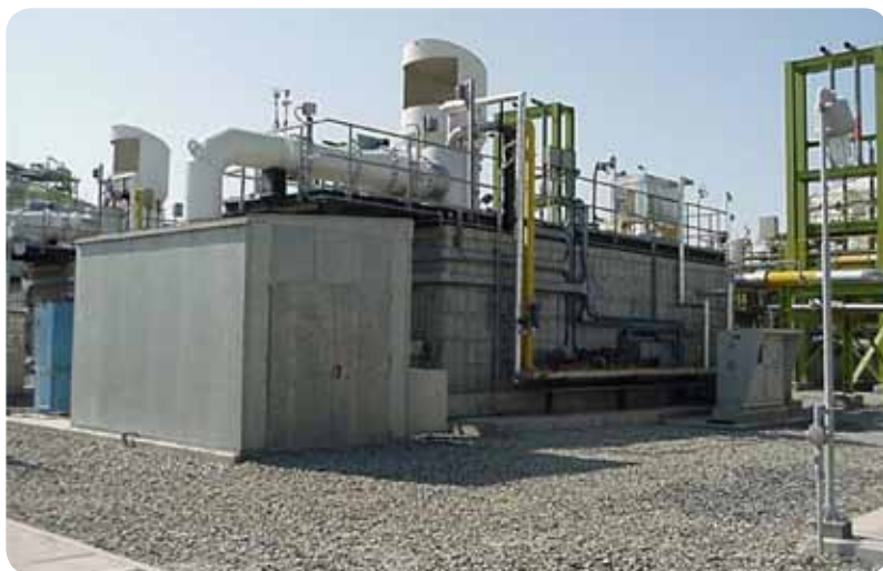
Kuva 13. Polttoainelämmitteinen höyrystyslaitos (SCV) (kuva: ConocoPhillips, 2004)
