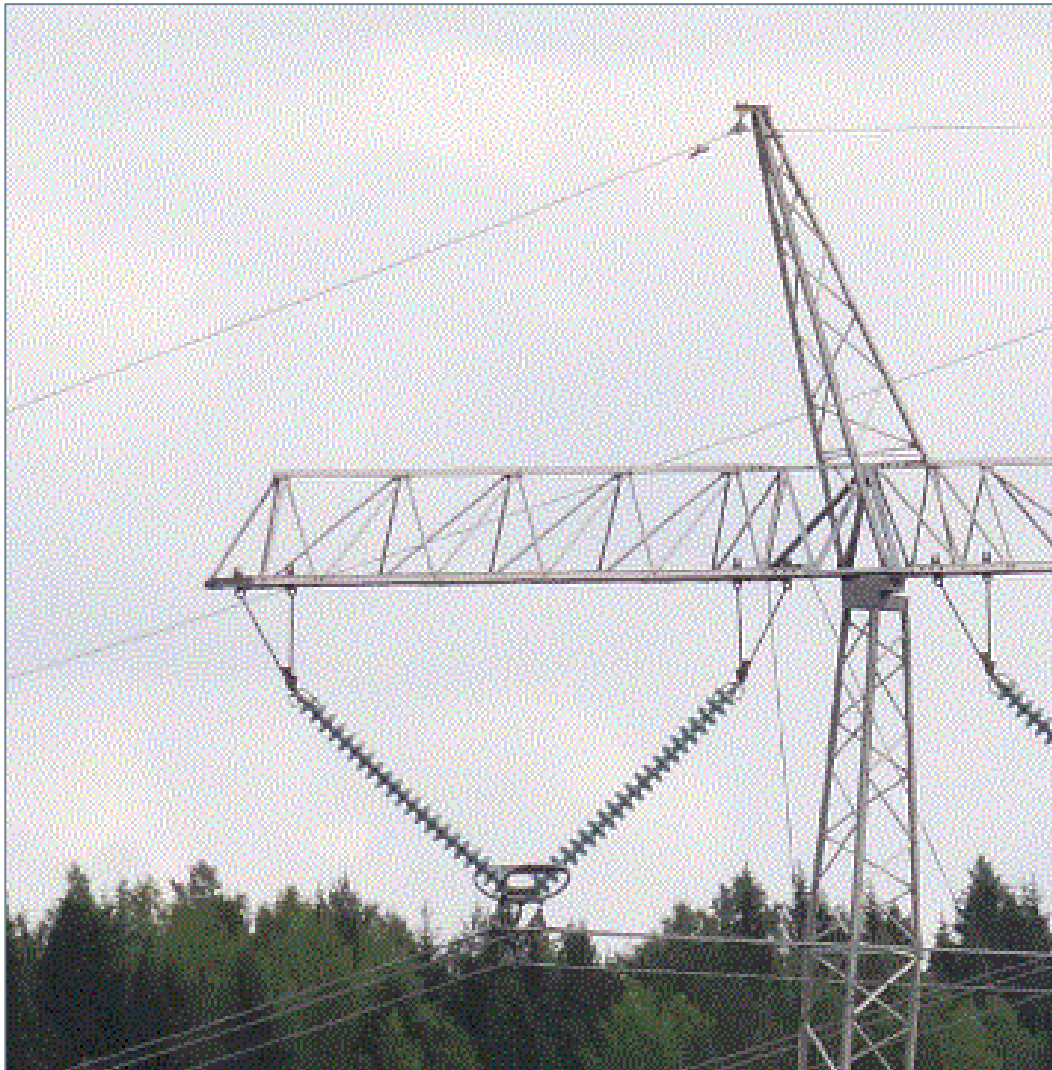
Kuva 16-5. Voimajohtopylvään eristimiä, joissa koronapurkauksia voi esiintyä.
