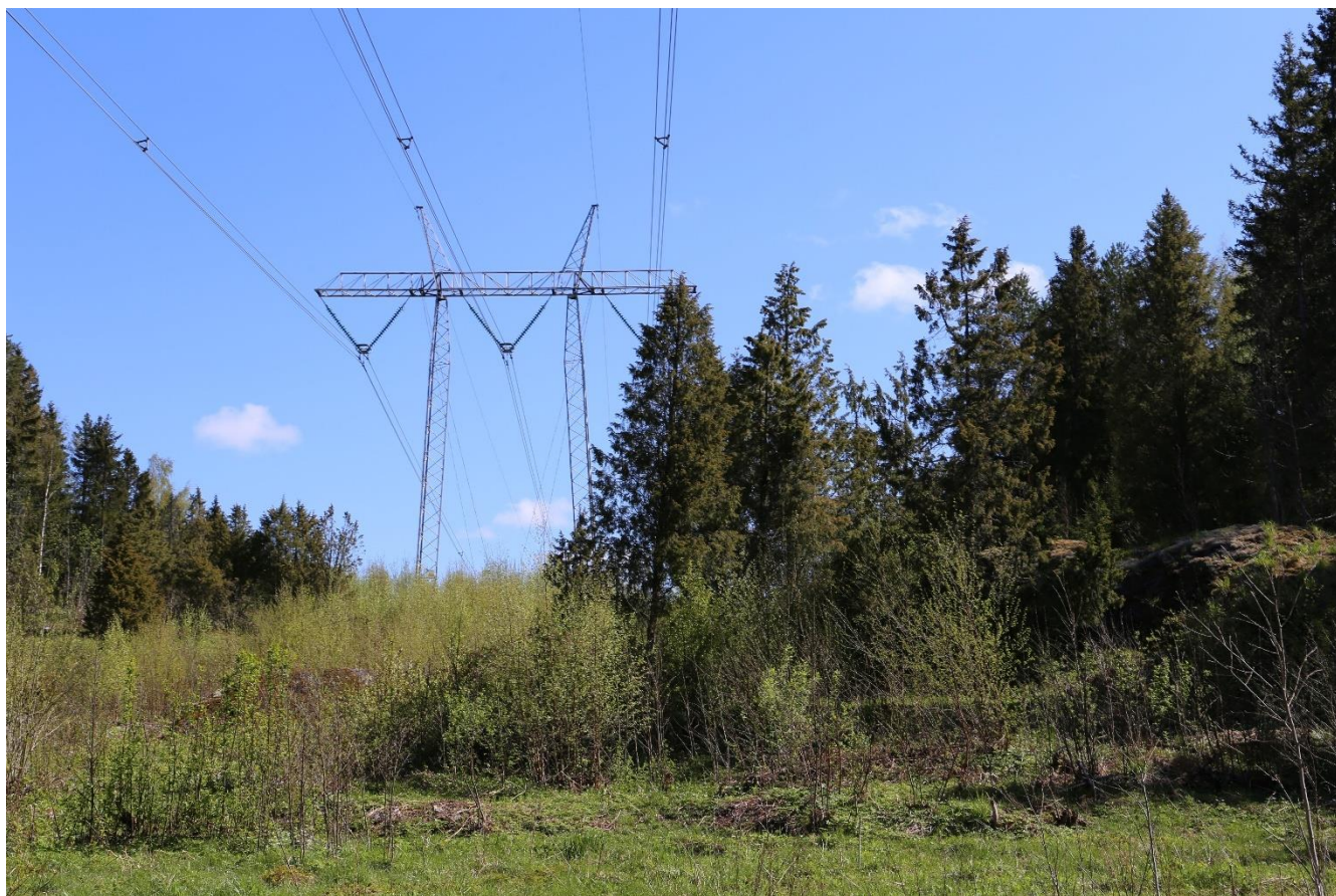
Kuva 12-30. Valokuva nykyisestä 400 kV voimajohdosta, joka sijoittuu paikoin Salmen ulkoilualueella ja ylittää ulkoilureitin. Uusi, suunniteltu voimajohto (osuus P_U-V) sijoittuisi kuvassa näkyvän voimajohdon oikealle puolelle (eteläpuolelle). Kuvauspaikka on esitetty kartoilla numerolla 22 (Liite 6). Kuvauspaikasta ei ole tehty havainnekuva.
