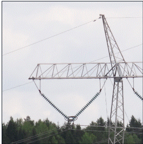
Kuva 6-5. Voimajohtopylvään eristimiä, joissa koronapurkauksia voi esiintyä.
