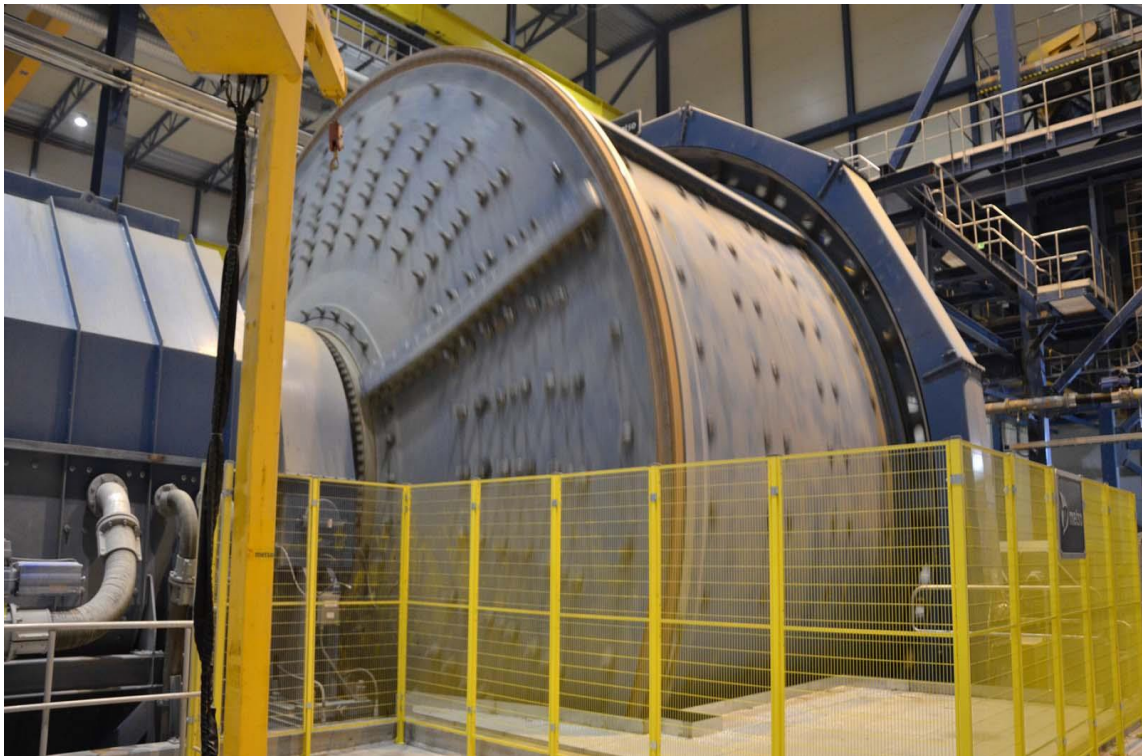
Kuva 25: Kuva rikastamon primäärimyllystä.
