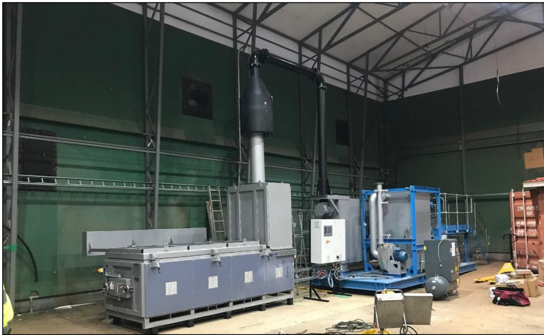
Kuva 4-15. Majasaaren jätekeskuksen koetoimintaluvalla oleva polttolaitos. Kattila esipolttokammio- ja jälkipolttokammioilla on kuvassa vasemmalla ja savukaasunpuhdistusyksikkö on kuvassa oikealla.
