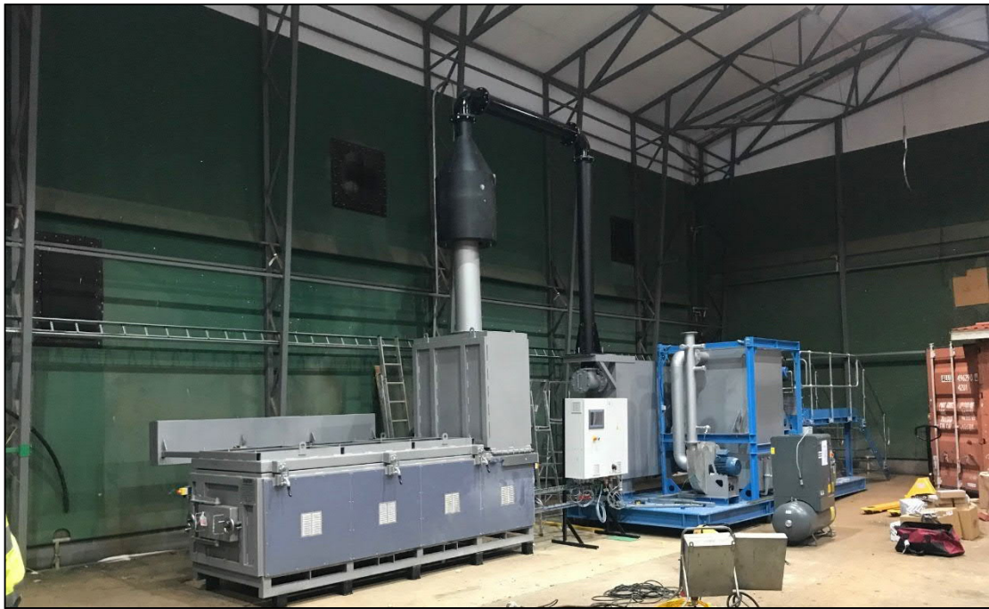
Kuva 4-13. Majasaaren jätekeskuksen koetoimintaluvalla oleva polttolaitos. Kattila esipoltto- ja jälkipolttokammioilla on kuvassa vasemmalla ja savukaasunpuhdistusyksikkö on kuvassa oikealla.
