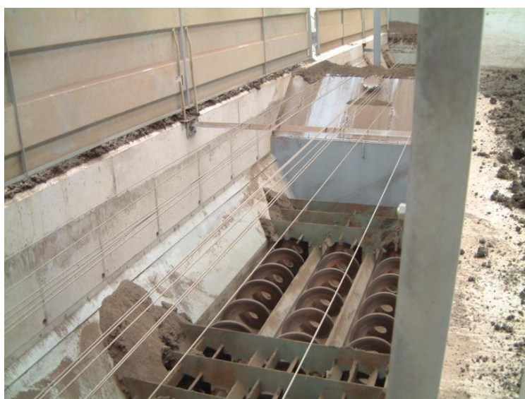
Kuva 15. Lietteensiirtoruuvit aurinkokuivauksesta polttoon (Outotec GmbH, Bad Vöslau, Itävalta).
