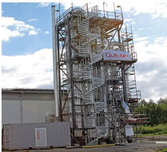
Kuva 13. Outotec (Finland) Oy:n lietteenkäsittelyn koelaitteisto toiminnassa Pohjois-Ruotsissa Skellefteåssa.
