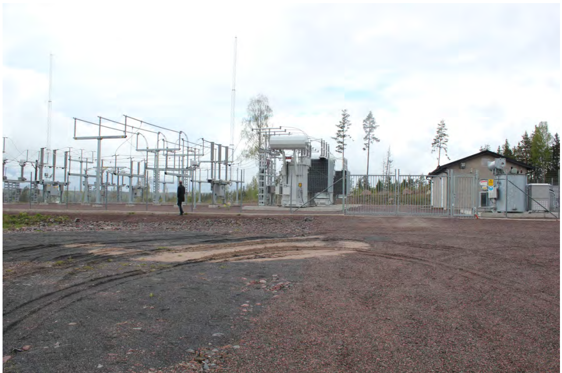
Figur 4-10. Exempel på en elstation för en ca 100 MW stor vindkraftpark (foto: Jakob Kjellman / FCG).
