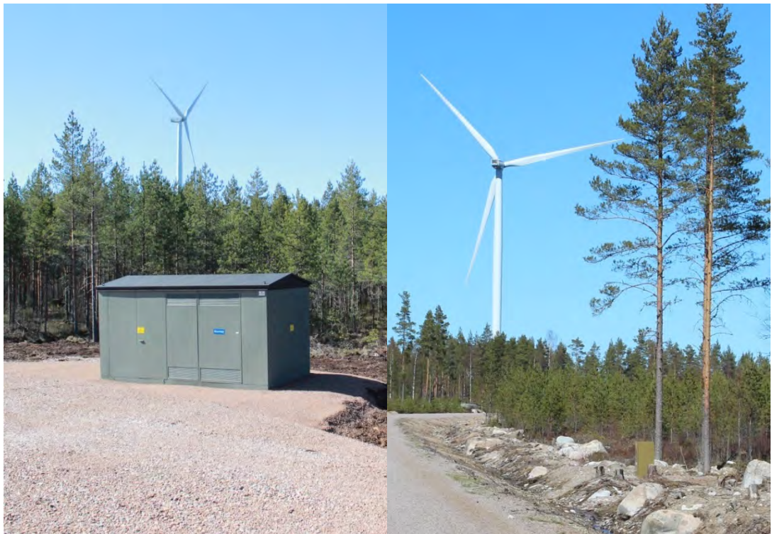
Figur 4-9. Exempel på vindkraftsverkets transformator placerat direkt intill kraftverket och jordkabelfördelningsskåp till höger (foto: Hans Vadbäck / FCG).
