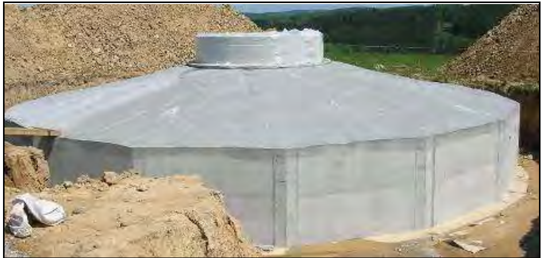
Bild 4.4. Typiskt markbaserat fundament för vindkraftverk i anläggnings-skedet.
