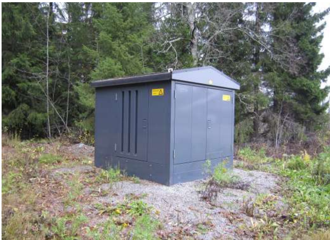
Kuva 3.13. Puistomuuntamot toimivat keskijännitekaapeleiden yhdistymispisteinä ja 1/20kV muuntajien suojarakennuksina (kuva: Janne Märsylä/ FCG).
