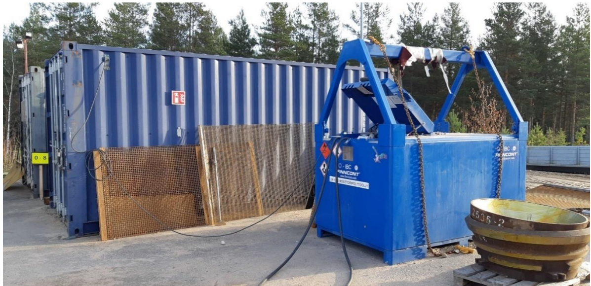
Kuva 2-7. Tukitoiminta-alueella sijaitsevat vaarallisten aineiden kontit ja polttoainesäiliö.
