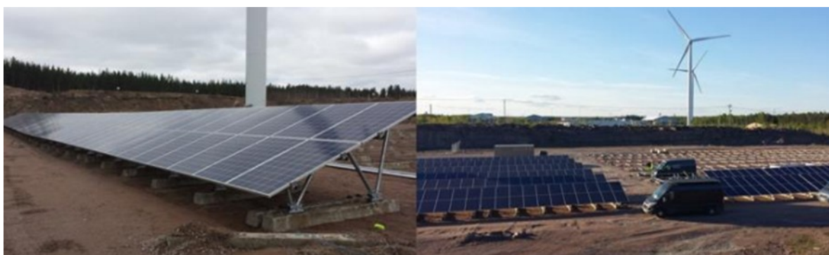
Kuva 4.8 Esimerkki aurinkopaneeleista (Suomen Voima Oy, Haminan Mäkelänkankaan aurinkovoimalat).
