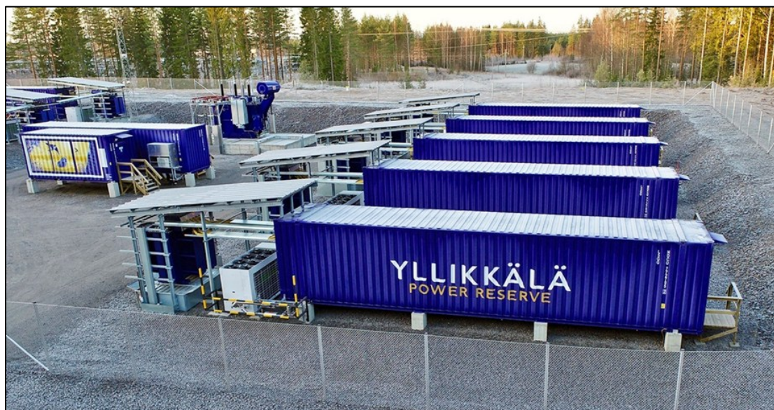
Kuva 4.13 Esimerkki sähkövarastosta, Neoenin Ylikkälän sähkövarasto (Lähde: https://www.kuljetuslehti.fi/2022/neoenin-akkuvarasto-toimittaa-nopeaa-varavoimakapasiteettia-tvolle-olkiluoto-3-voimalaitosyksikon-kayttoonoton-aikana/ )
