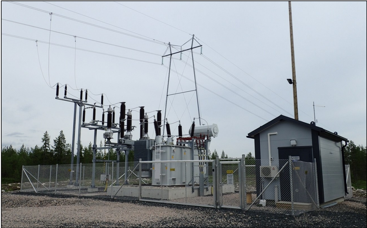
Kuva 4.14 Esimerkki tuulivoimapuiston sähköasemasta (FCG Finnish Consulting Group Oy).
