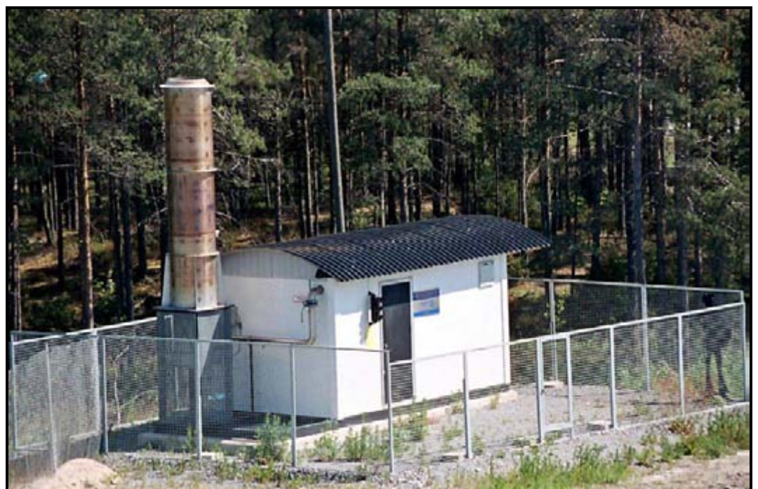
Kuva 17. Kaatopaikkakaasun pumppaamo ja soihutupoltin
