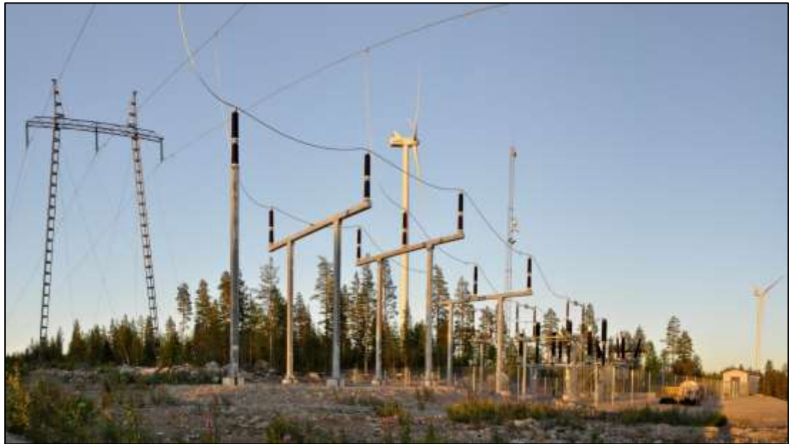
Kuva 5.12. Esimerkki tuulivoimapuiston sähköasemasta. (Kuva: Leila Väyrynen / FCG)
