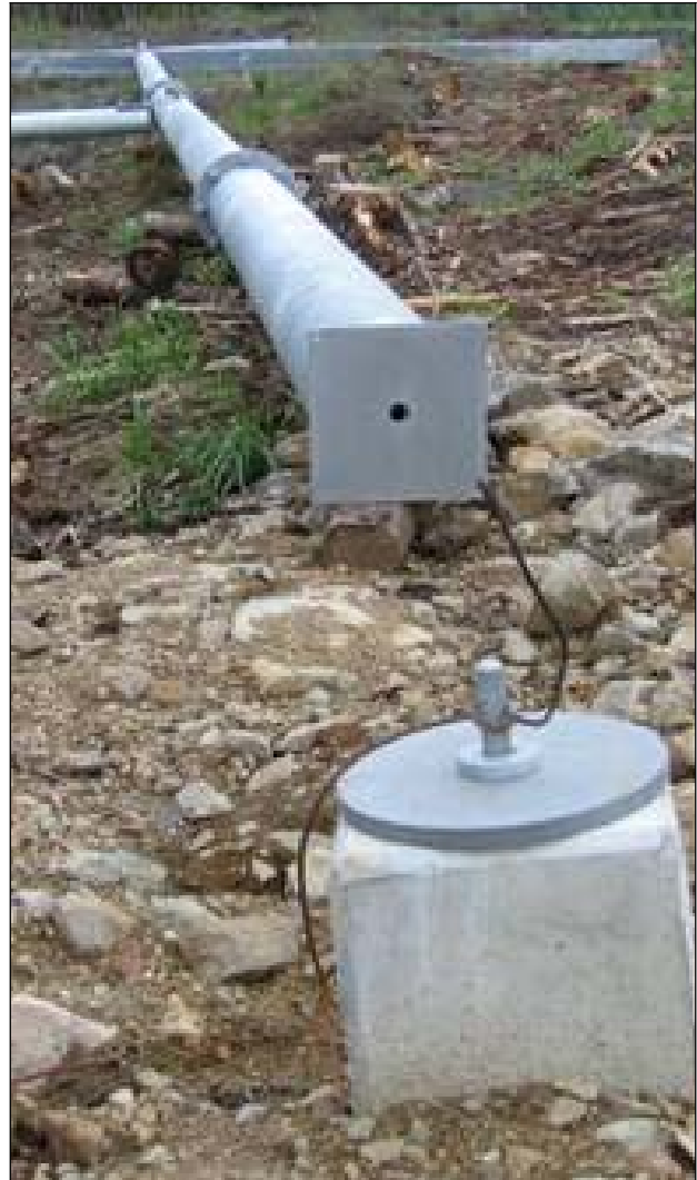
Kuva 7. Pylväsjalan perustus ja maadoituselektrodijohdin.
