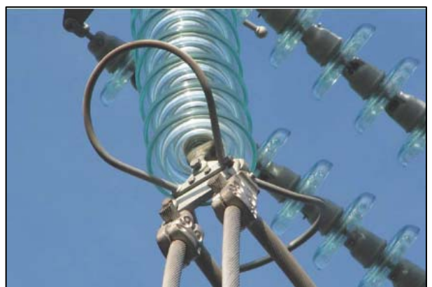
Kuva 67. Voimajohtojen eristimissä esiintyy koronapurkauksia.
