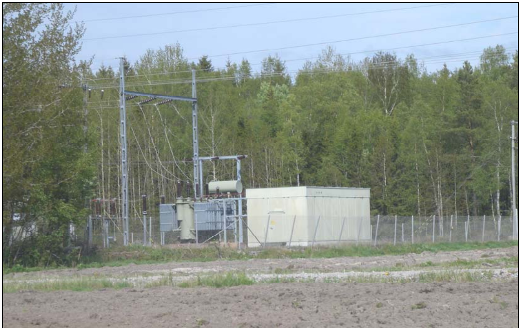
Kuva 17. Esimerkki sähköasemasta (Kuva: Mattias Järvinen / FCG).
