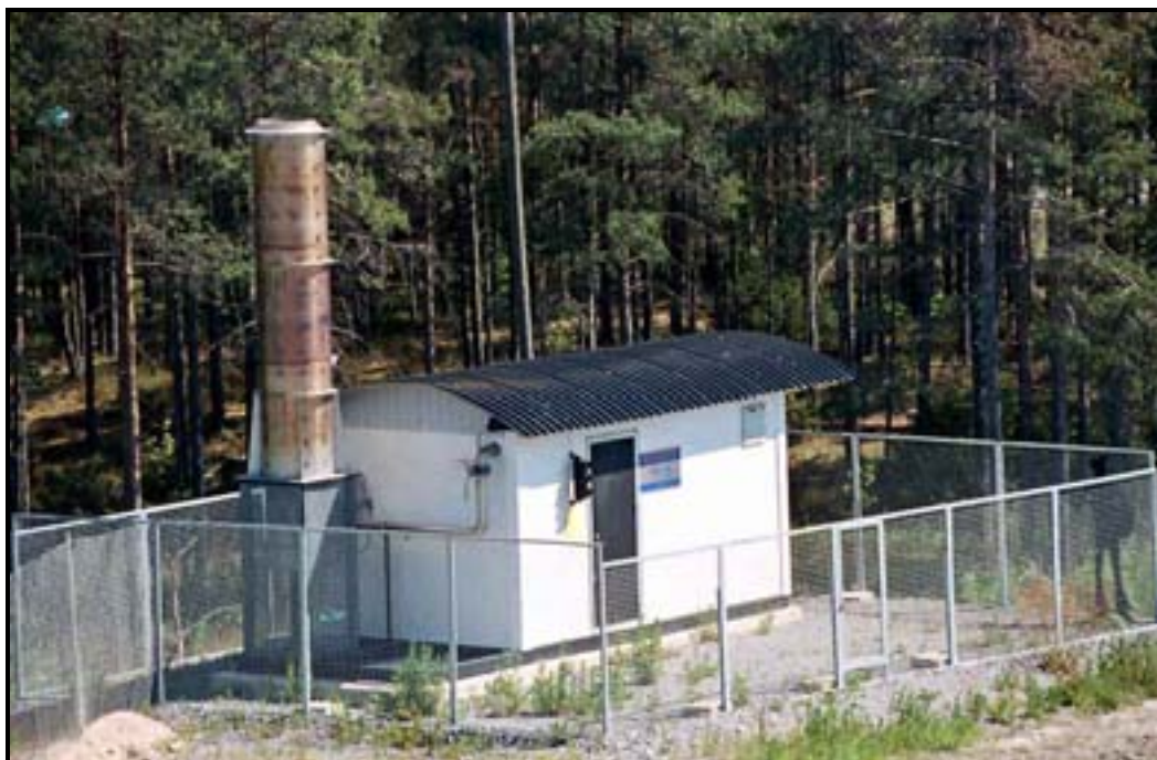
Kuva 13. Kaatopaikkakaasun pumppaamo ja soihutopltin
