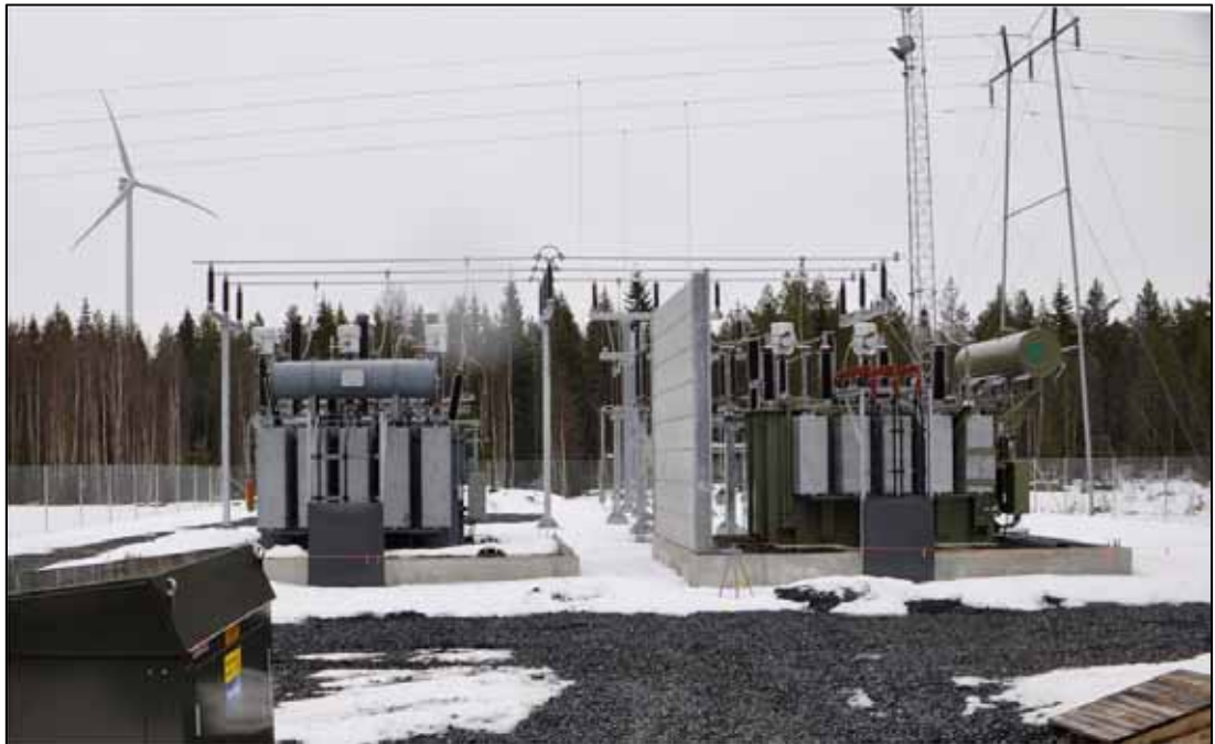
Kuva 5.10. Esimerkki tuulivoimapuiston sähköasemasta. (Kuva: Leila Väyrynen / FCG)
