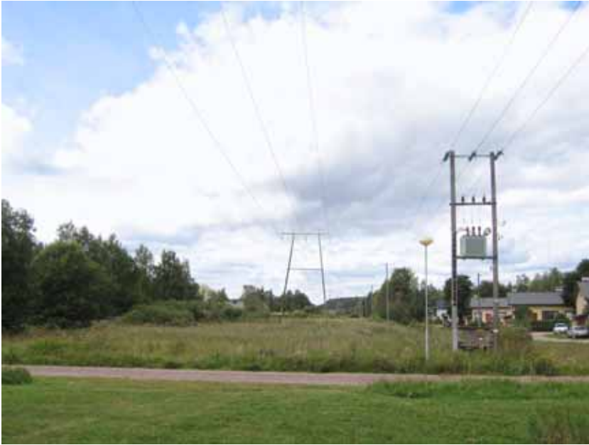
Kuva 42b. Alavaihtoehtoon A yhteispylväsratkaisuna toteutettu 400 + 100 kV voimajohto.
