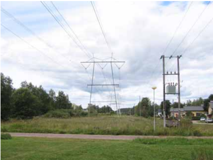
Kuva 42c. Alavaihtoehtoon B, C tai D toteutuessa Riihimäen taajamaan jäävä saneerattu 110 kV voimajohto.
