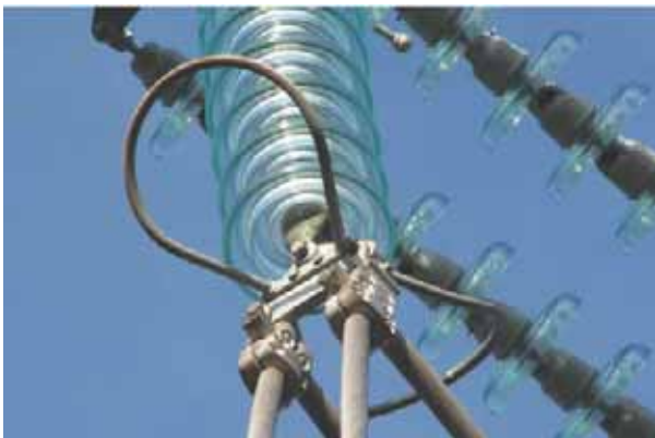
Kuva 87. Voimajohtojen eristimissä esiintyy koronapurkauksia.
