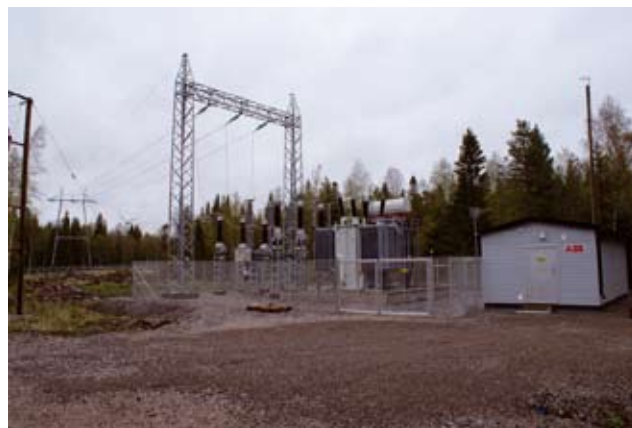
Kuva 3-5. Ajoksen nykyinen sähköasema.
