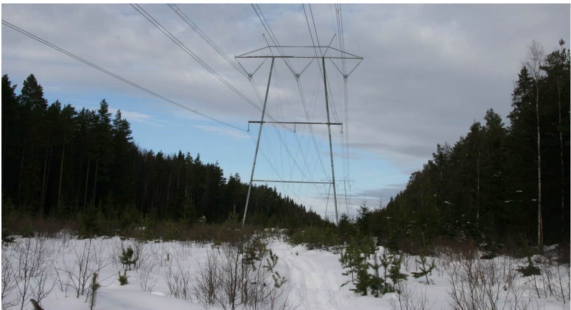
Kuva 3.5. Esimerkkikuva 400+110 kV voimajohtoon johtoalueen maastokäytävästä (Kuva: Tuulialfa 2024).
