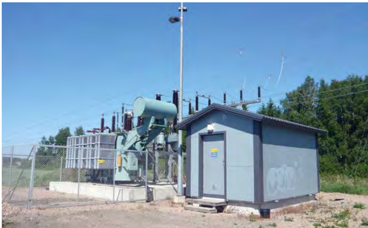
Kuva 5-3. Esimerkki muuntoasemasta. (Kuva Tiina Harpila, wpd Finland Oy).
