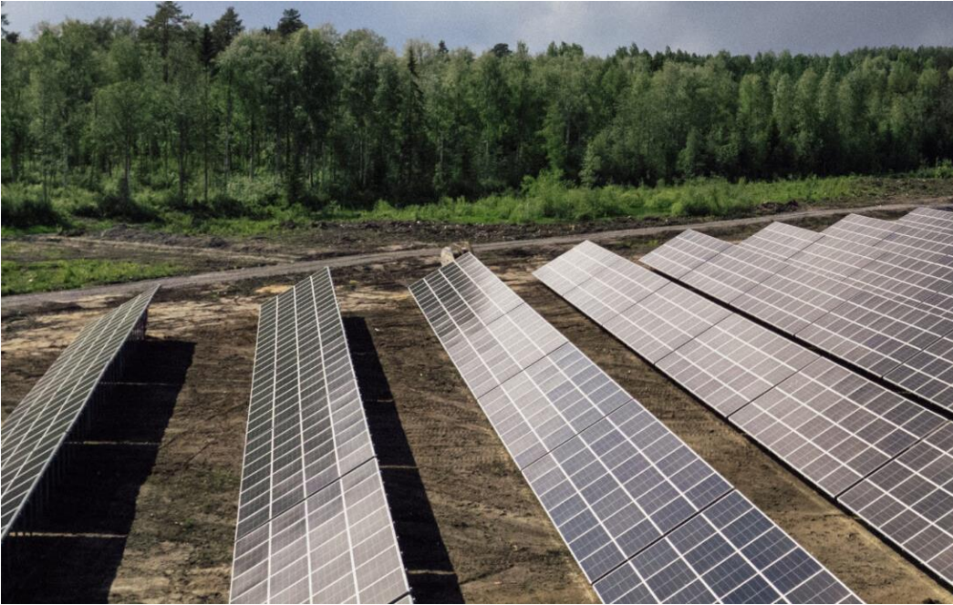
Kuva 10. Esimerkkikuva aurinkopaneeliriveistä. Kuvassa Ilmatar Energy Oy:n Joroisten lentokentän alueen aurinkovoimapuisto. Kuva: Ilmatar Energy Oy
