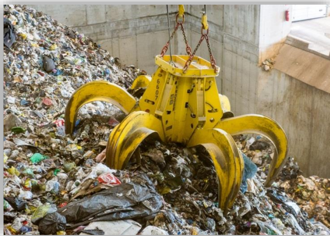
Kuva 2. Jätettä jätebunkkeriin syöttävä kahmari.
