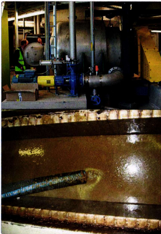
Kuva 4-11. Pulperointisäiliössä (vasen kuva) erotetaan mädätyksprosessiin soveltuva liete (oikea kuva). Oikeanpuoleisessa kuvassa lietteen kuiva-ainepitoisuus on noin 10 %.
