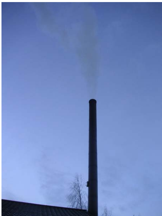
Kuva 15. Lämmitysrakennuksen savupiippu koepolton sytytysvaiheessa.
