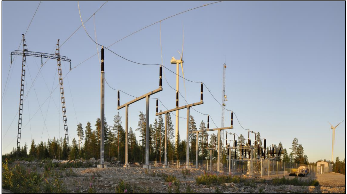
Kuva 5.6. Esimerkkikuva tuulivoimapaiston 20/110 kV sähköasemasta. (Kuva: Leila Väyrynen / FCG).
