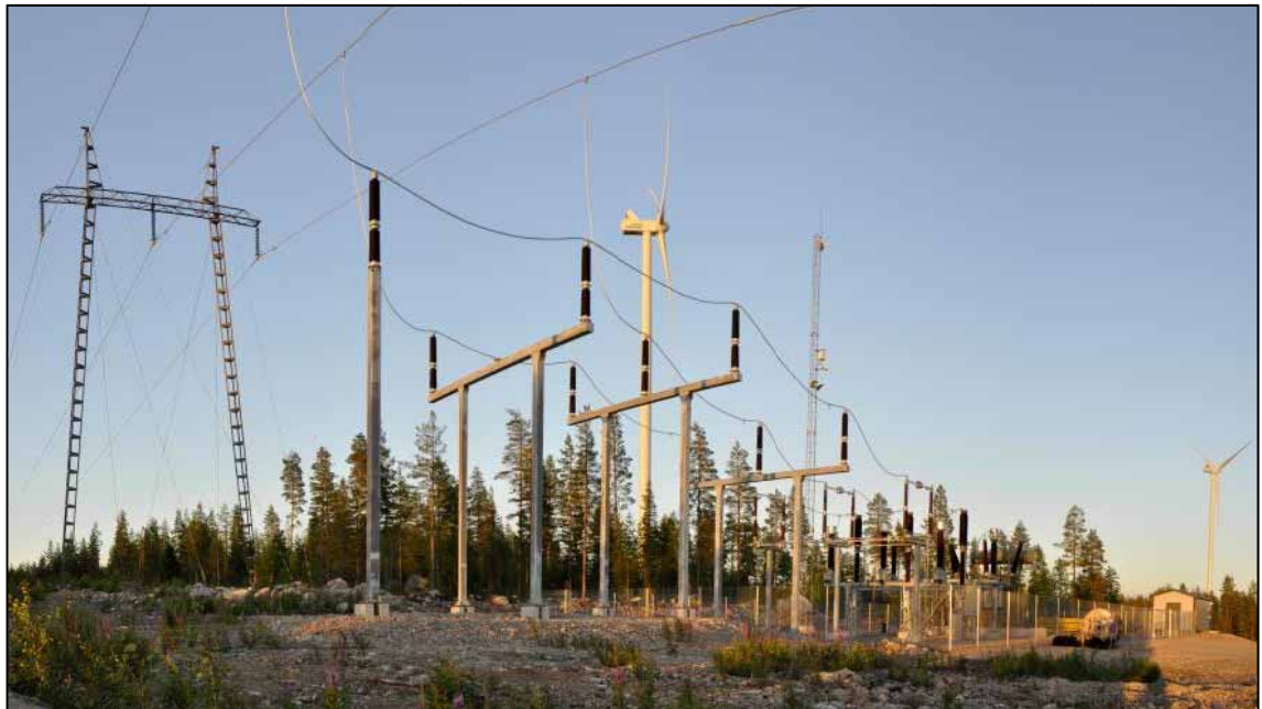
Kuva 4.10. Esimerkkikuva tuulivoimapuiston 110/20 kV sähköasemasta. (Kuva: Leila Väyrynen/FCG).
