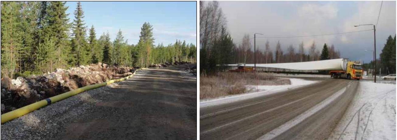
Kuva 4.6. (Vasemmalla) Esimerkki tuulivoimapuiston rakennus- ja huoltotiestä. Teitä käytetään muun muassa betonin, soran ja voimaloiden komponenttien kuljetuksiin sekä tuulivoimapuiston käyttövaiheessa huoltoajoihin. Maakaapeli sijoitetaan ojakaivantoon tien reuna-alueelle (Kuva: Ville Suorsa / FCG).
