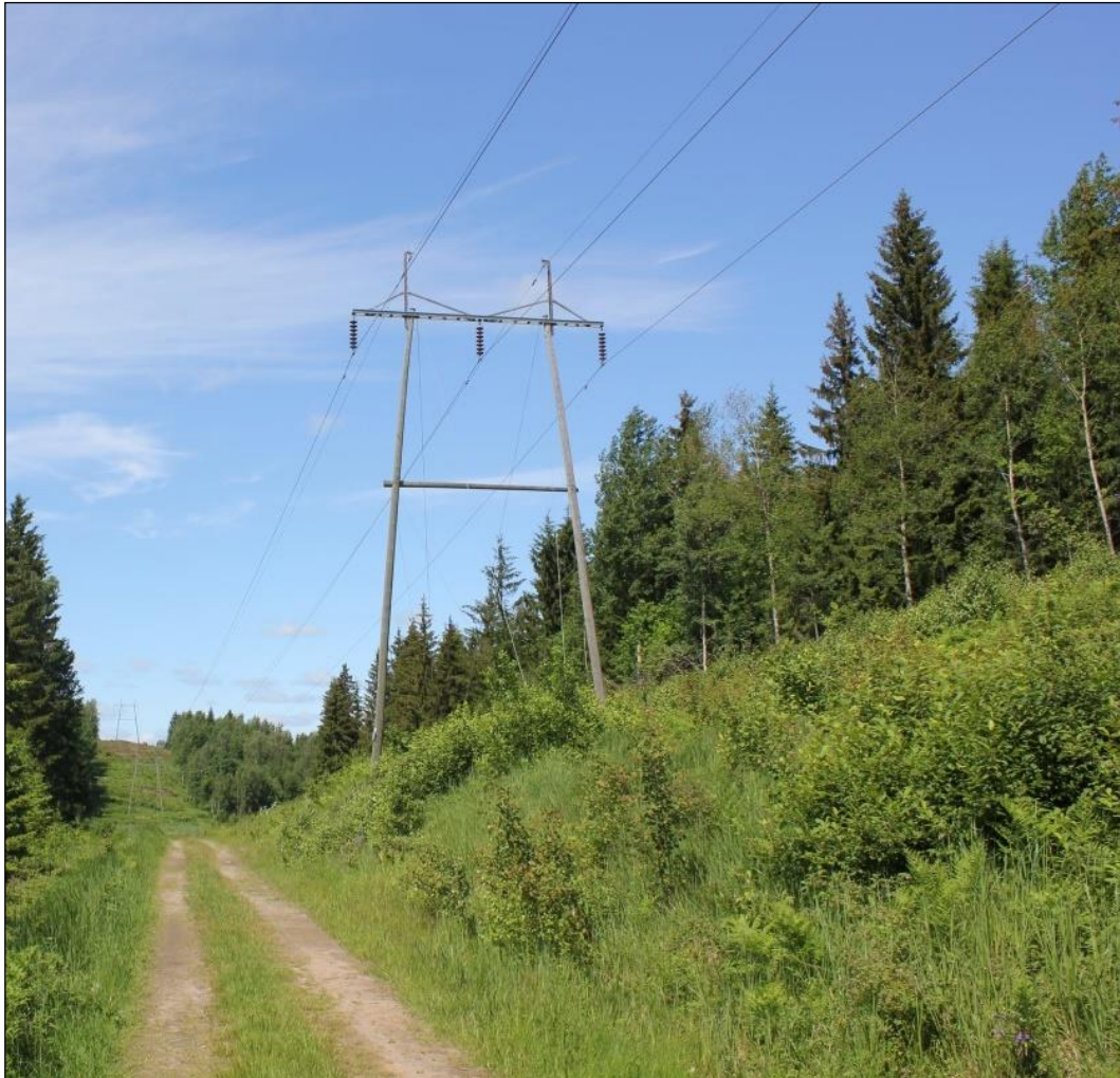
Kuva 4-14. Esimerkki yhden virtapiirin 110 kV ilmajohdosta. Johtoaukealla on yleensä puun taimia ja pensasmaista kasvillisuutta. Johtoaukea pidetään puustosta vapaana. Johtoaukean vieressä on huoltotie joka on myös maa- ja metsätalouden käytössä (Kuva: Mattias Järvinen / FCG).
