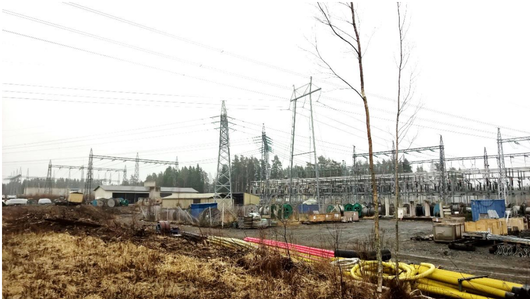
Kuva 16-7. Seinäjoen sähköasema kuvattuna rautatien suunnasta koilliseen (kuva: Suvi Järvinen / FCG).
