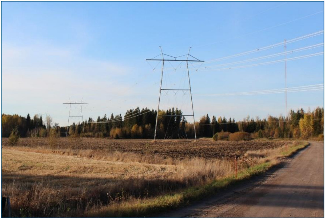
Kuva 4-3. Seinäjoki-Tuovila 400+110 kV voimajohto. Suunniteltu 2*110 kV voimajohto sijoittuisi noin 6 kilometrin osuudella sen viereen (Kuva Hans Vadbäck / FCG).
