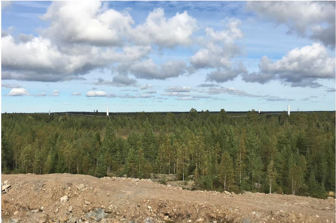
Kuva 33. Vuonna 2017 linnustovaikutusten seurannan aikana saadaan tietoa mm. Simon tuulivoimapuistojen laajentumisen vaikutuksesta alueen linnustoon ja lintujen muuttoreitteihin. Kuvassa Leipjön rakenteilla olevan II-vaiheen tuulivoimaloita kesällä 2016.
