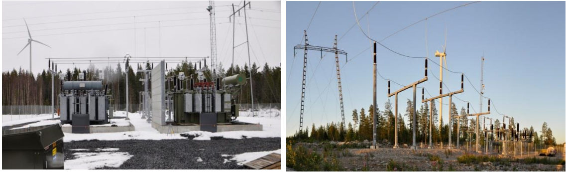
Kuvapari 4.14. Esimerkkikuvia tuulivoimapaiston 110/20 kV sähköasemasta. (Kuva: Leila Väyrynen/FCG).
