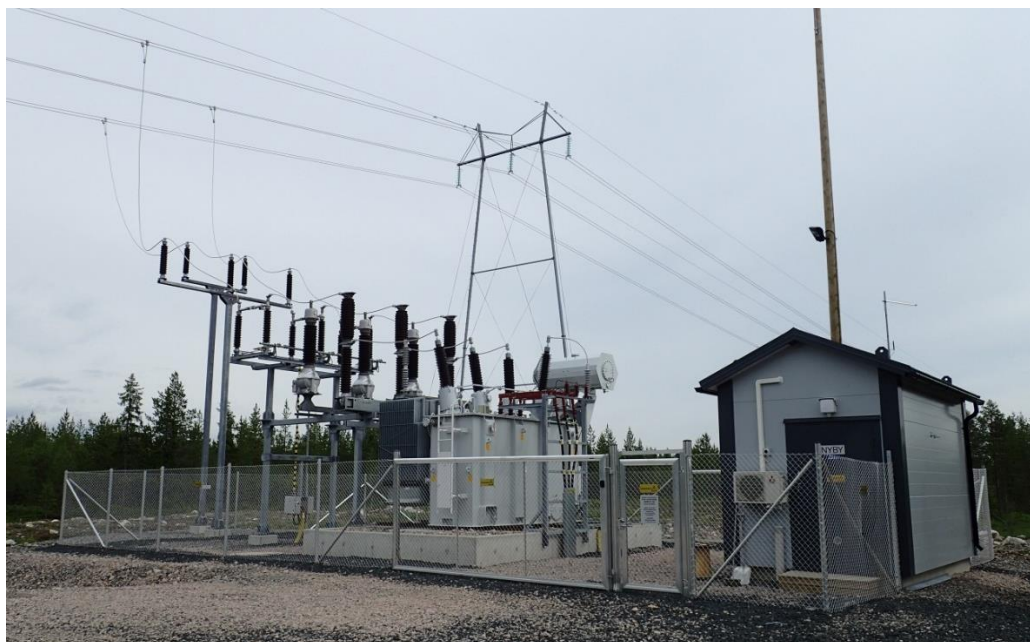
Kuva 5-10. Esimerkki tuulivoimahankkeen sähköasemasta (Minna Takalo, FCG).
