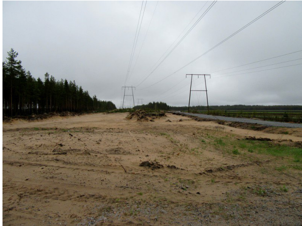
Kuva 32. Voimalinja Läntisenmutkan kohdalla kuvattu koilliseen.
